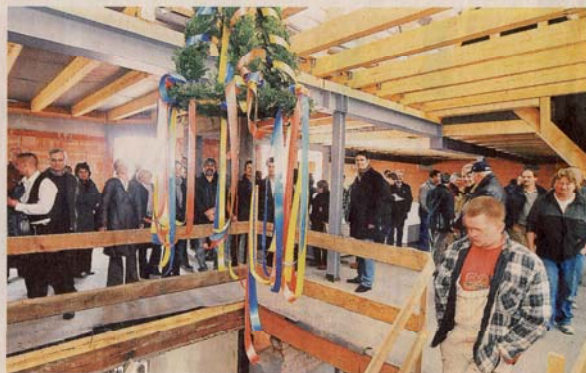
Richtfest im neuen Dach der Markgrafenstraße 10: Aus dem ehemaligen Nachtcafé wird ein komfortables Gästehaus für Geschäftsleute. Foto: Norman Rembarz
